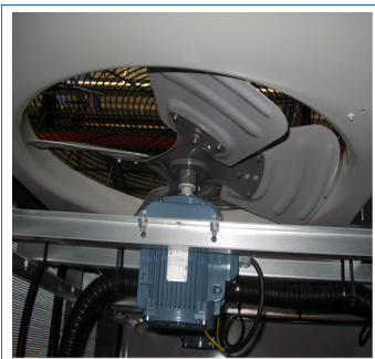
Condenser Fan Motor
